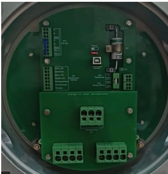
Рисунок 5 - Внешний вид бокса подключения энергонакопителя
